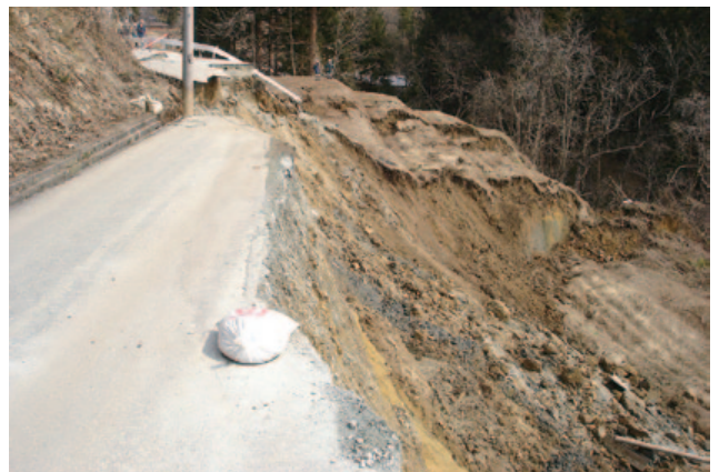
平成18年4月7日発生地すべりによる災害(大船木)
