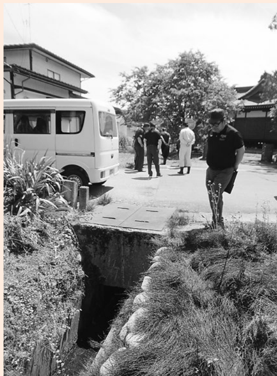
早急な対応が望まれる和合堰路拡張整備
