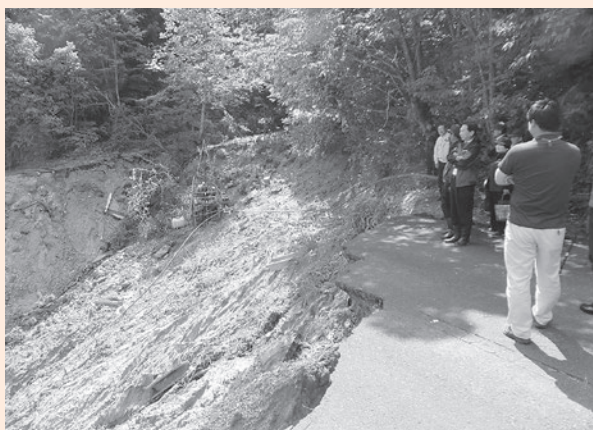
町道立木ブナ峠線崩落現場
