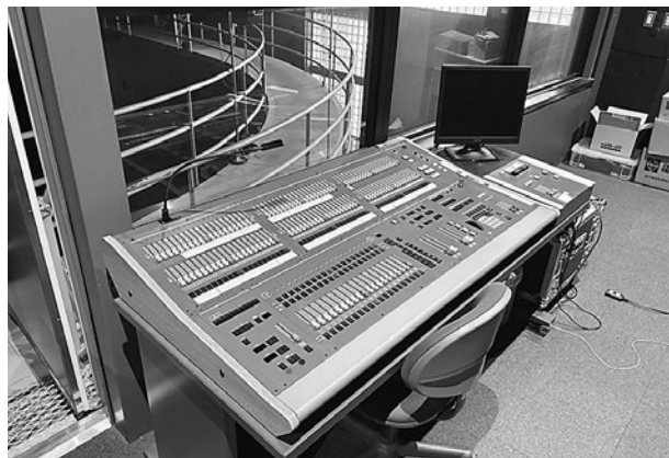
改修される創遊館ホールの照明操作卓
