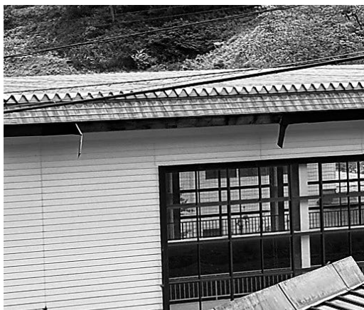
強風で破損した旧立木小体育館学校
