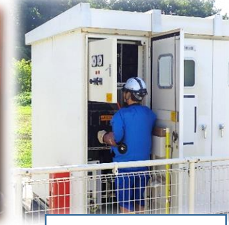
電気設備点検
