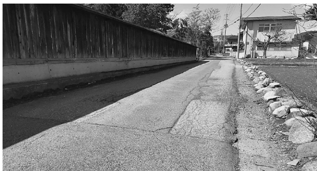
消流雪溝が設置される町道大谷中央線（大谷三地内）
