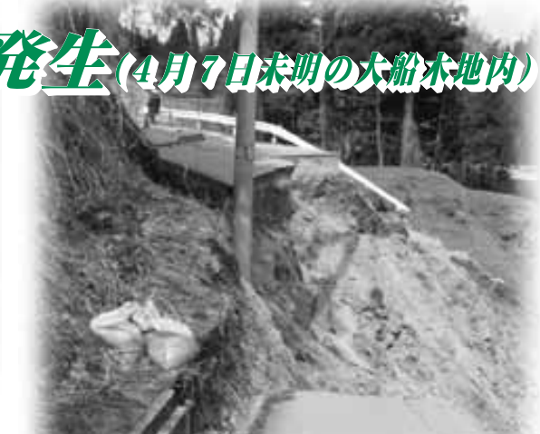
生活路が完全に崩落（現場から松程方面に向かって撮影）
